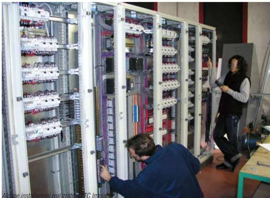
Alcune installazioni realizzate da TC Impianti.
